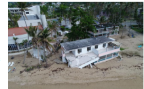
Imagen 1. Fallo de la estructura sujeto a oleaje, olas y erosión.
