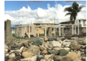
Imagen 2. Estructura con daños severos en la Zona Costera de Punta Santiago.
